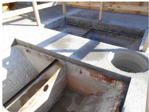
Station de traitement des eaux de chantier (Mies)
