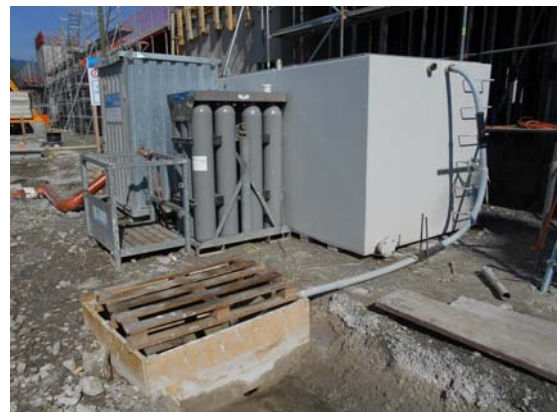
SER du lot 2, unité de traitement des eaux de la centrale à béton (Implenia), B+C Ingénieurs, mars 2017
