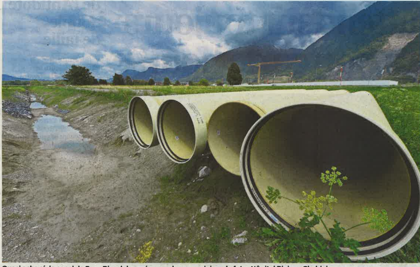
Quasi achevé, le canal de Praz-Riond devra évacuer les eaux claires du futur Hôpital Riviera-Chablais. CHANTAL DERVEY
