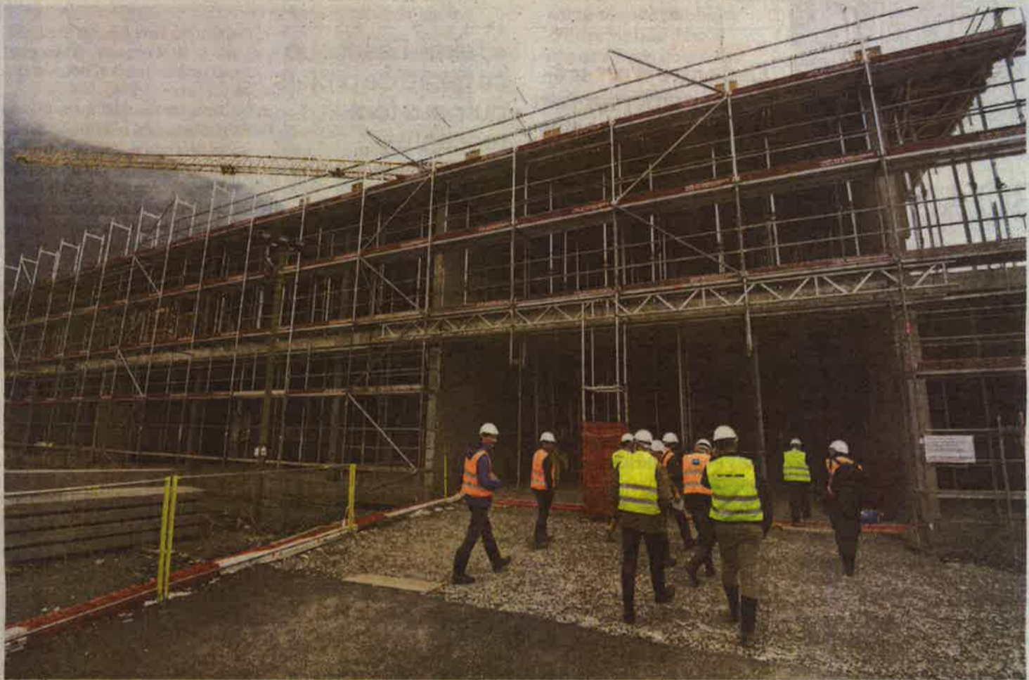
Sur le chantier de Rennaz, la cadence doit rester soutenue pour tenir le délai de décembre 2018. PATRICK MARTIN
